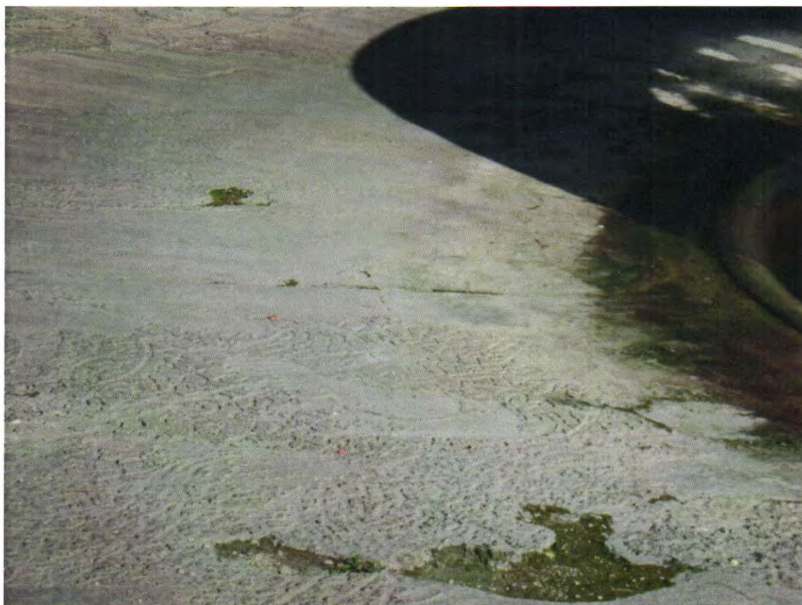
Fig.5 - Foto dei mosaici degradati
