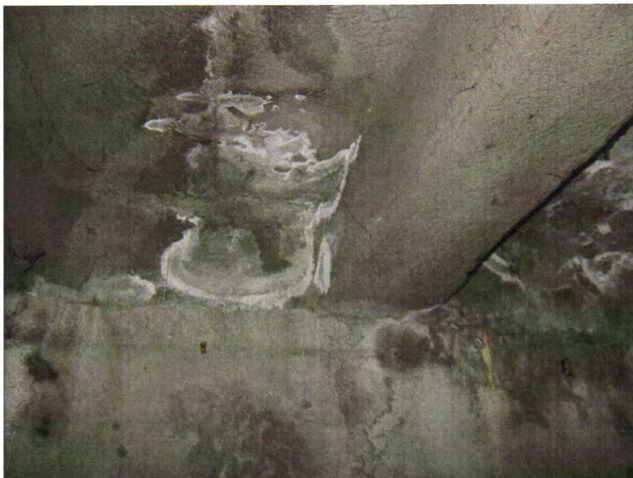
Fig. 16- Efflorescenze sul solaio di copertura del vano pompe
